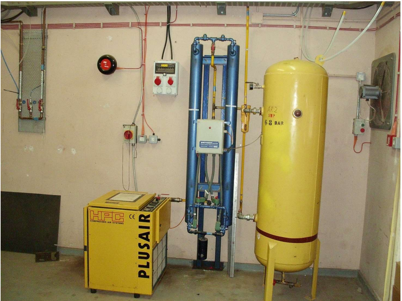
Compresor de aire seco del WHT situado en la sala de bombas de aceite
