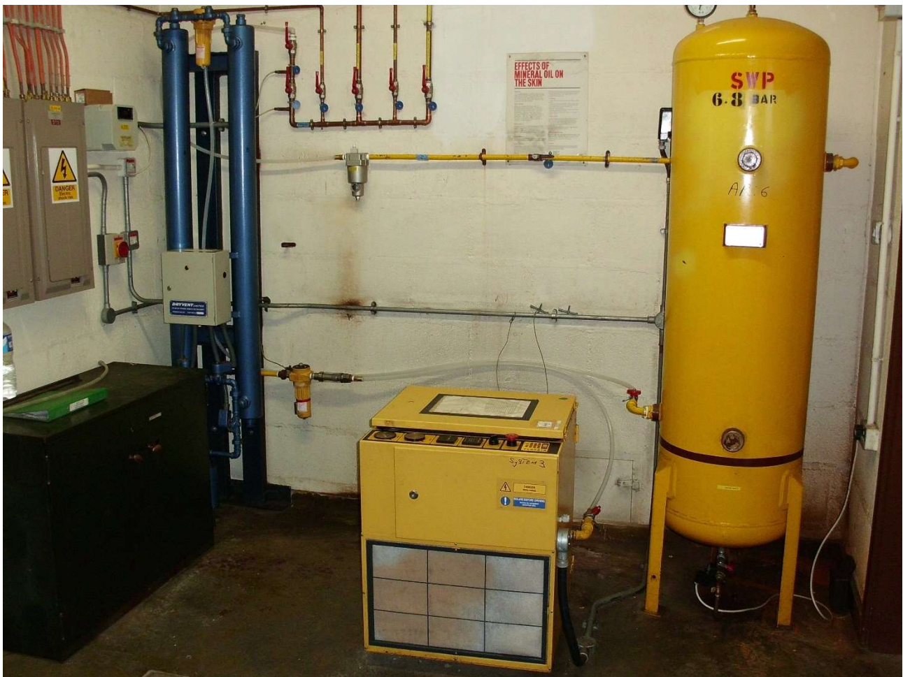
Compresor de aire seco del INT situado en la sala de bombas de aceite
